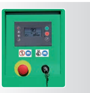
Программируемая электронная панель управления компрессорной станцией
